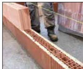
Après avoir réglé le 1 er rang sur le mortier d'assise le collage des blocs ThermoPlan® peut commencer. Simple, vite et propre.
